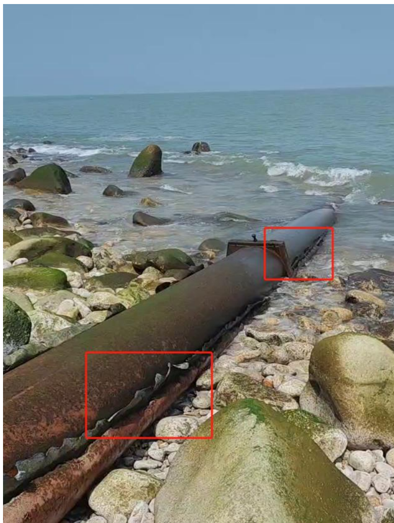
图 1.1-2 海管登陆段外保护层破损裸露照片
