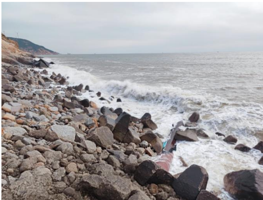
图 2.1.5-2 海管登陆段外保护层破损裸露踏勘照片
